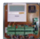
Obvodová deska, transformátor, svorkovnice
