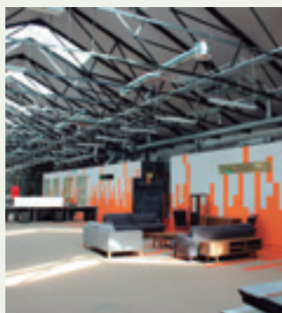
Řešení společnosti Zalando pro přestavbu její kanceláře ve skladu v Grand Canal Quay, Dublin. ECOi
